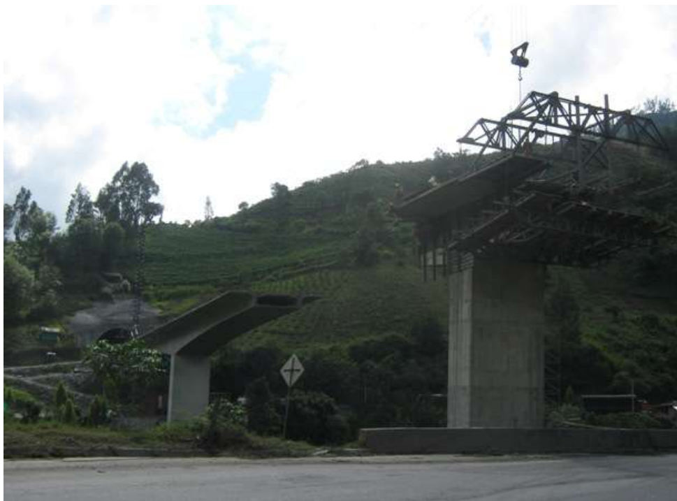
Foto No 3: Viaducto "Porvenir", localizado entre el km42+540 y el km42+696. Se observa en la foto: Trabajos de construcción dovela No 1
