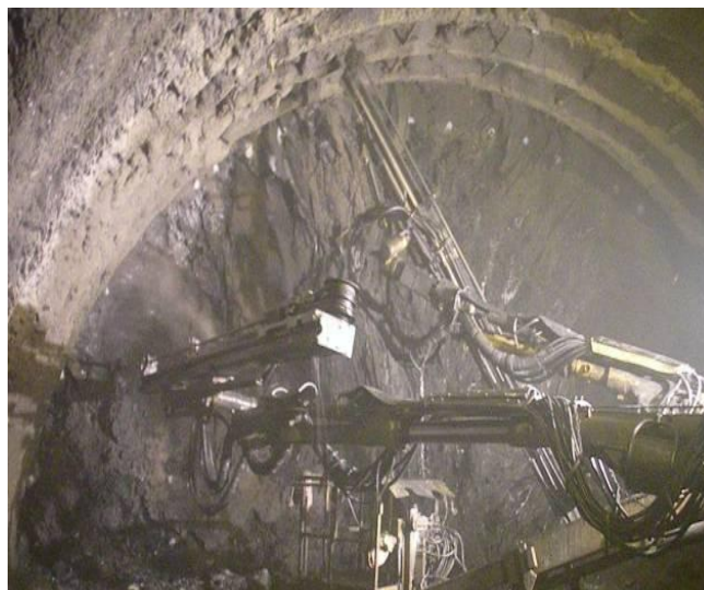
Foto No 1: Túnel II Centenario Frente Tolima- Galería No 8 hacia Tolima Se observa: Perforación Frente de excavación para instalar pernos radiales.
