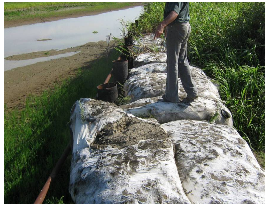
Obras ejecutadas primeros 200 m. del Rompedero Potrero Nuevo, año 2004, Convenio 588/04 con FONADE.
